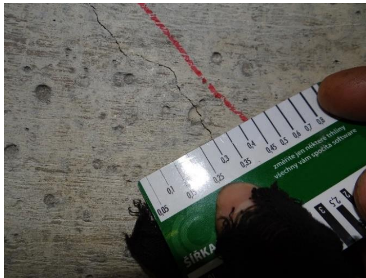
Obr. 16 Šířka největší trhliny při zatížení 658 kN
